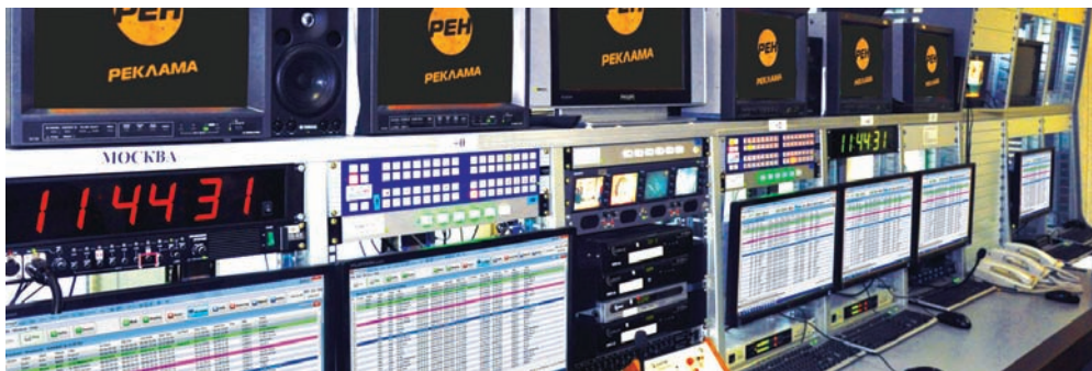
Оборудование SkyLark в составе технологического комплекса «РЕН-ТВ»
